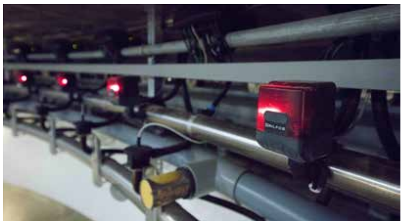
Eletrônicos montados sob a plataforma para proteção contra água.
