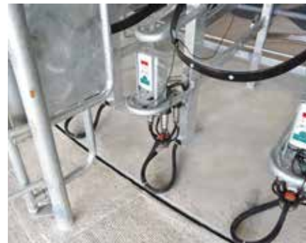
Posicionamento do sistema de automação.
